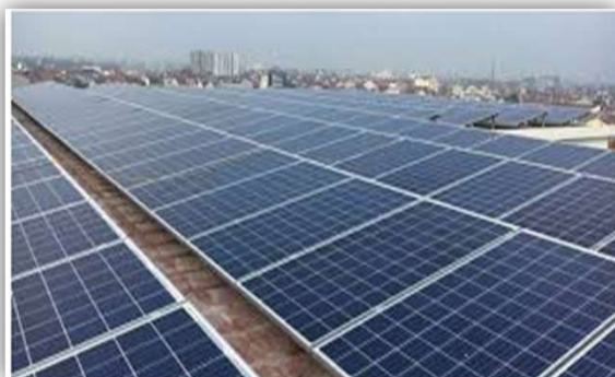
Công ty 4M Green Power-Hậu Giang
